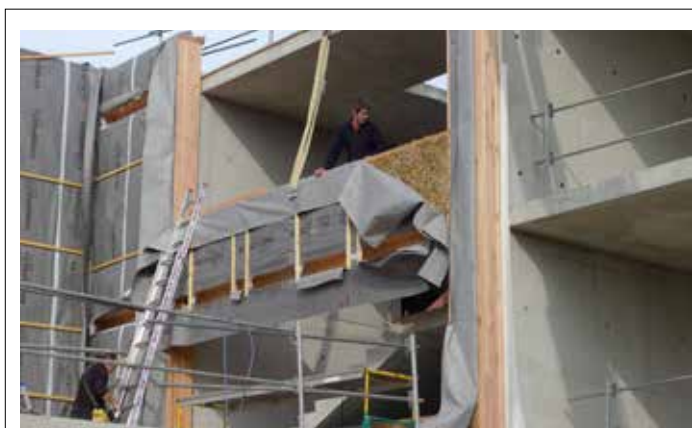
De la paille, matériau biosourcé utilisé comme isolant (siège de l'intercommunalité).
