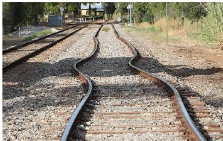
Figure 108 : Déformation de rails lors de la canicule de 2003 sur la ligne de RER D
